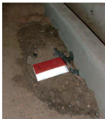
FIGURA 8 – Material retirado dos drenos nas ombreiras (basalto)
