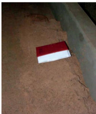
FIGURA 7 – Material retirado dos drenos na região em arenito
