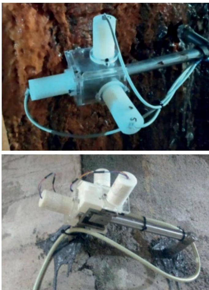
FIGURA 5 – Automação de medidor triortogonal
