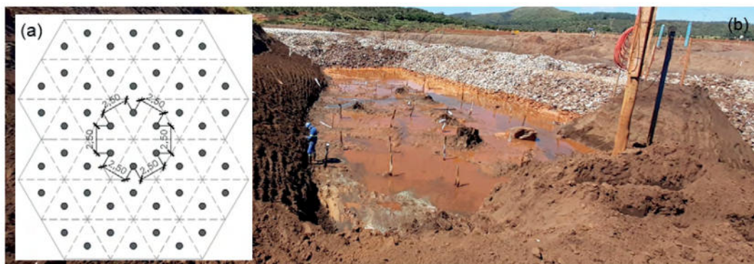
FIGURA 2 – Distribuição dos drenos fibroquímicos (a) em planta e (b) no pé da pilha – Malha triangular
