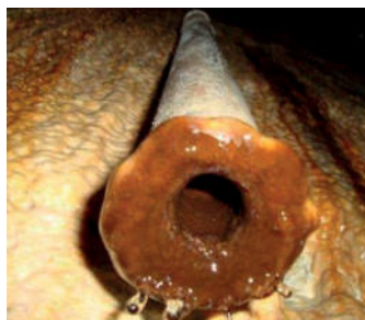
FIGURA 11 – Detalhe de dreno com seção bem comprometida pela carbonatação (JUN/2010)
