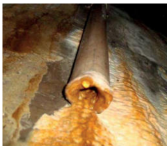
FIGURA 10 – Tubulação de drenagem do CCR parcialmente obstruída por carbonato de cálcio (JUN/2010)
