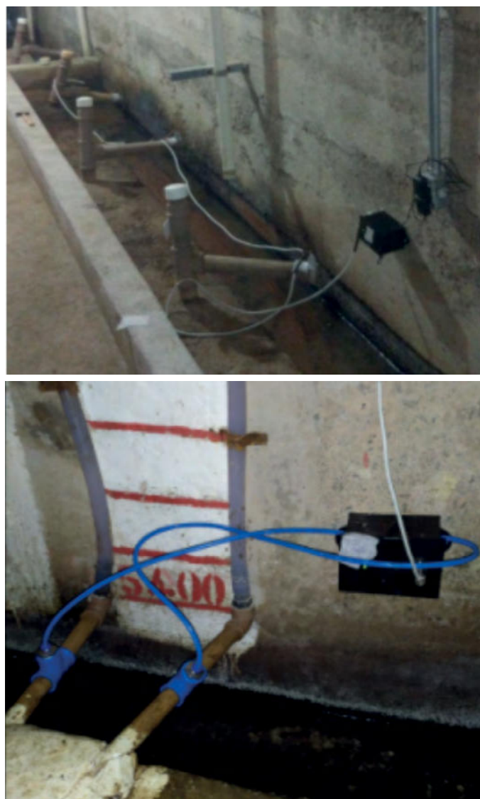
FIGURA 6 – Automação de drenos (esquerda) e piezômetros de tubo (direita)
